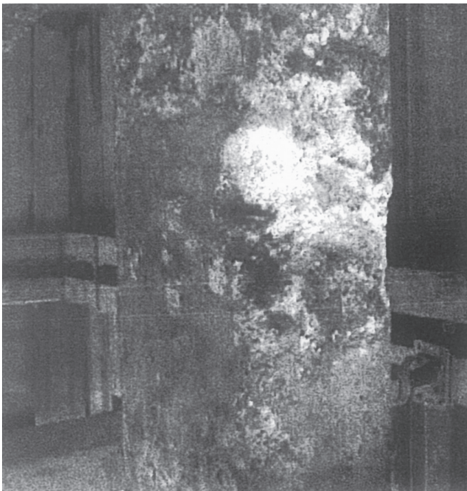
Rys. 1. Korozja siarczanowa z utworzeniem thaumasytu w przypadku betonu konstrukcyjnego obejmującego pal zastosowany na autostradzie 145 w Anglii. (Zdjęcie wykorzystane dzięki uprzejmości Halcrow Group Ltd, Swindon, Wiltshire, UK)
